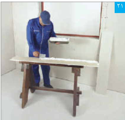
۲۱ اجرای چسب گچی پنل (پرفلیکس) بر پشت پنل نواری (به اجرای یکپارچه چسب گچی پنل توجه شود)
