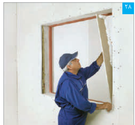
استقرار پنل نواری در ناحیه داخلی دور بازشوی پنجره (به اجرای یکپارچه چسب گچی پنل (پرفلیکس) توجه شود)
